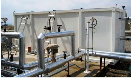
Latentwärmespeicher Almeria DLR
