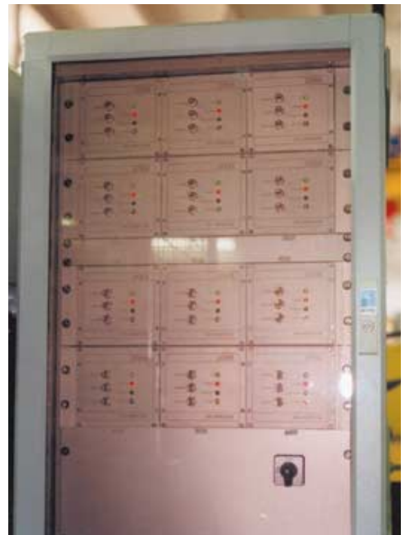
Abb. 6: Schaltschrank mit 12 Hochspannungsverstärkern zur Ansteuerung der ERF-Ventile)
