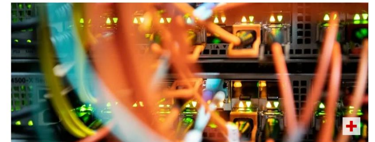
Glasfaserkabel stecken in einem Rechenzentrum (Symbolbild) FOTO: MATTHIAS BALKDPA
