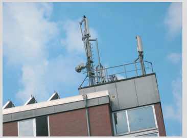
Heute: mit Mobilfunkstation und Solaranlage (Dach des 50-Bettenhauses)
